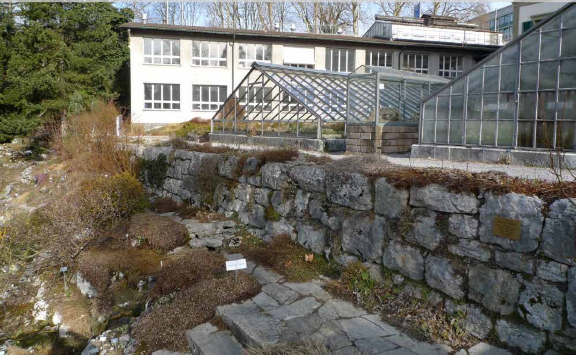
Unverfugtes Mauerwerk, Gartenanlage: Mauereidechse, Zauneidechse, Blindschleiche
